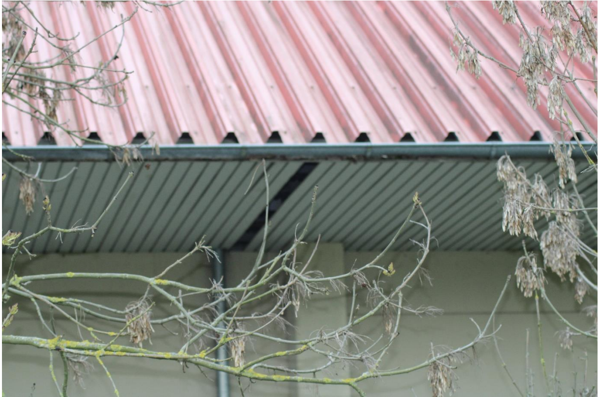
Abbildung 13: Detail defekter Dachkasten
