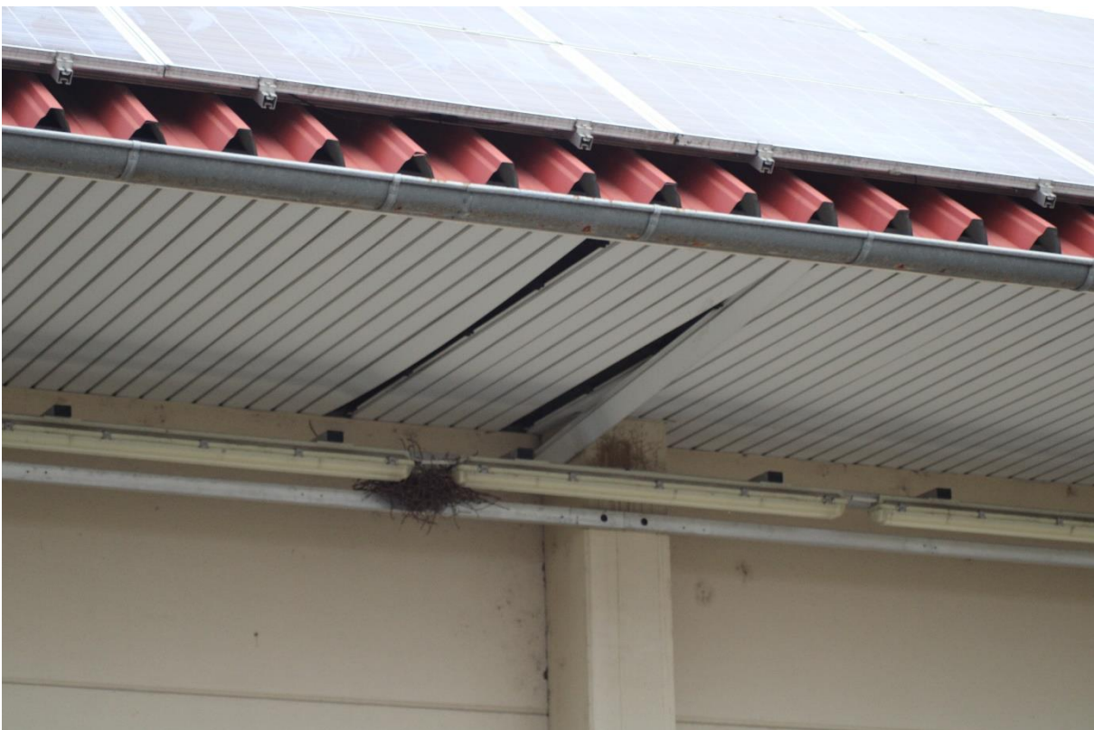
Abbildung 16: Detail defekter Dachkasten und Nestbauversuch
