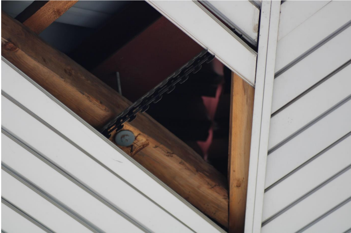
Abbildung 11: Detail defekter Dachkasten
