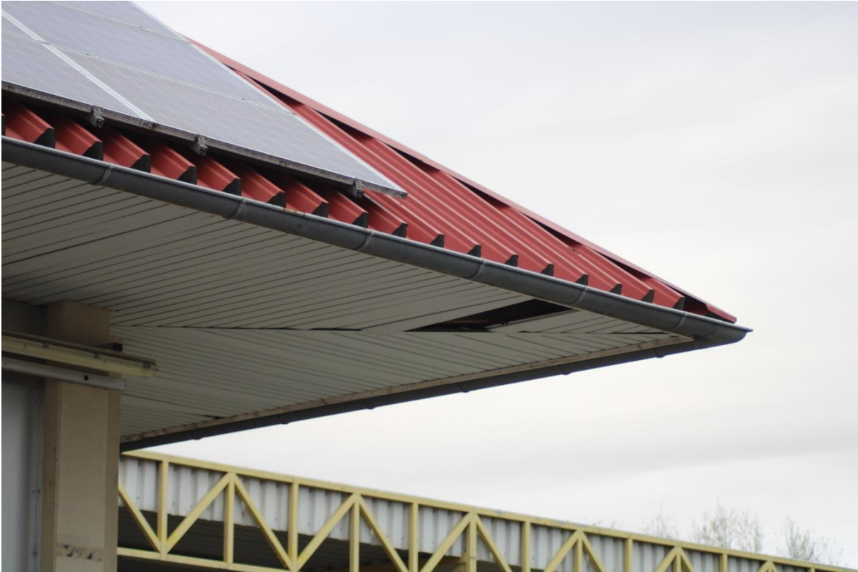
Abbildung 15: Detail defekter Dachkasten
