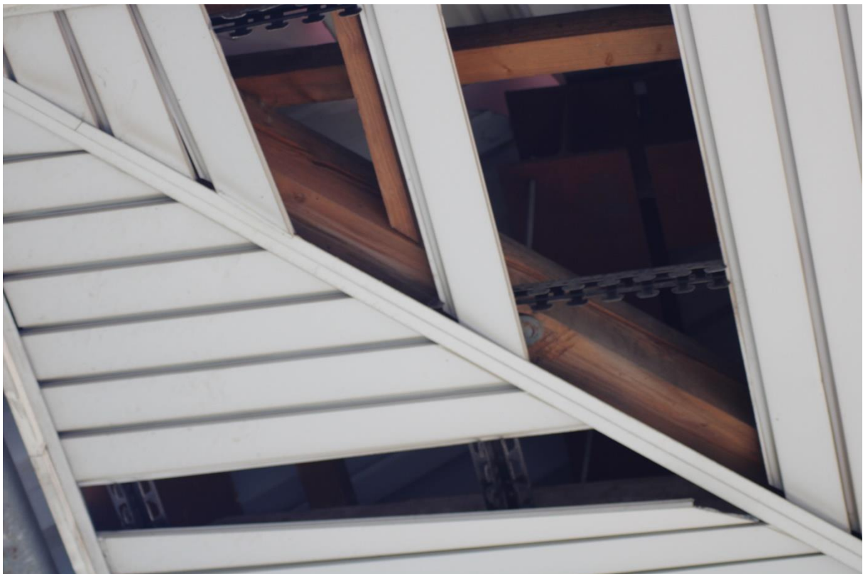
Abbildung 10: Detail defekter Dachkasten
