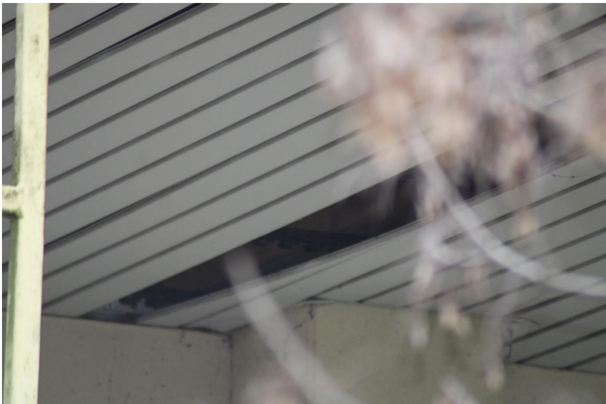
Abbildung 12: Detail defekter Dachkasten
