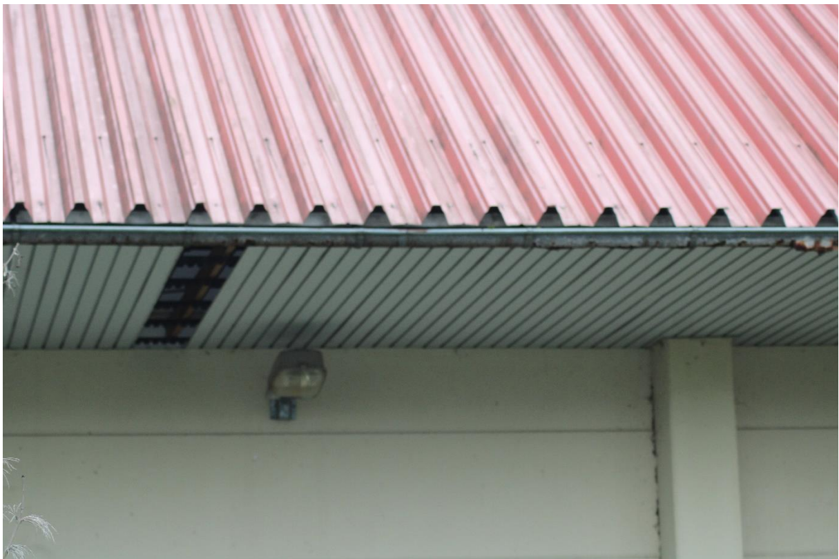
Abbildung 14: Detail defekter Dachkasten
