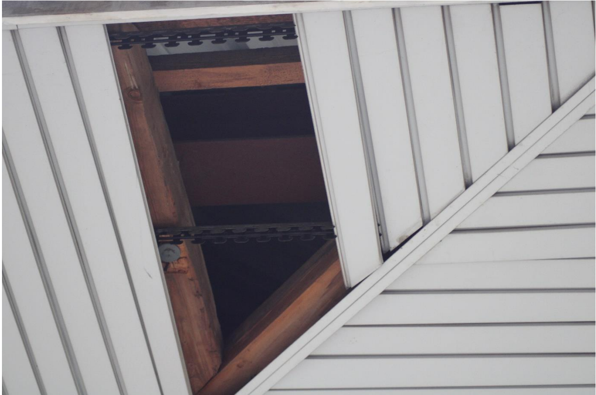
Abbildung 9: Detail defekter Dachkasten
