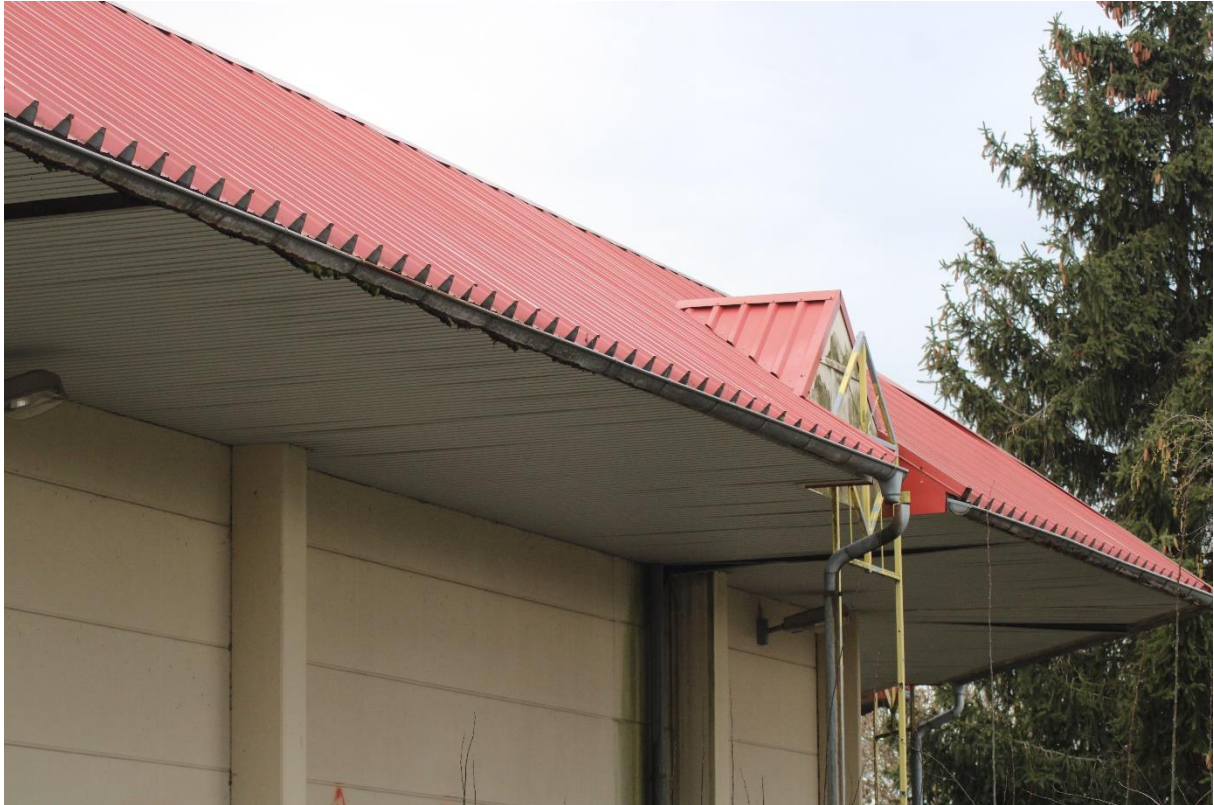
Abbildung 17: Detail defekter Dachkasten
