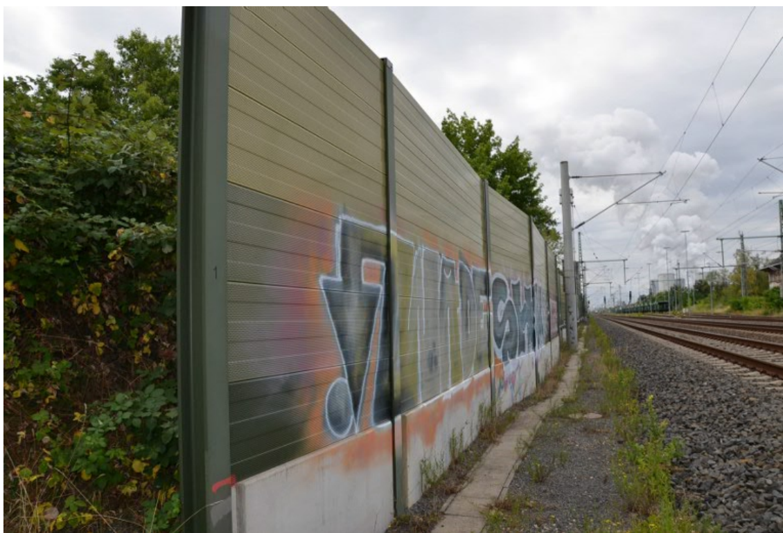
Bild 10: Nahansicht der Lärmschutzwand; zu erkennen ist die schallabsorbierende Ausführung (nur gleisseitig)
